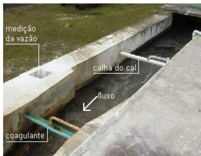
Figura 9 – Dosador de cal e de coagulante em calha parshall
