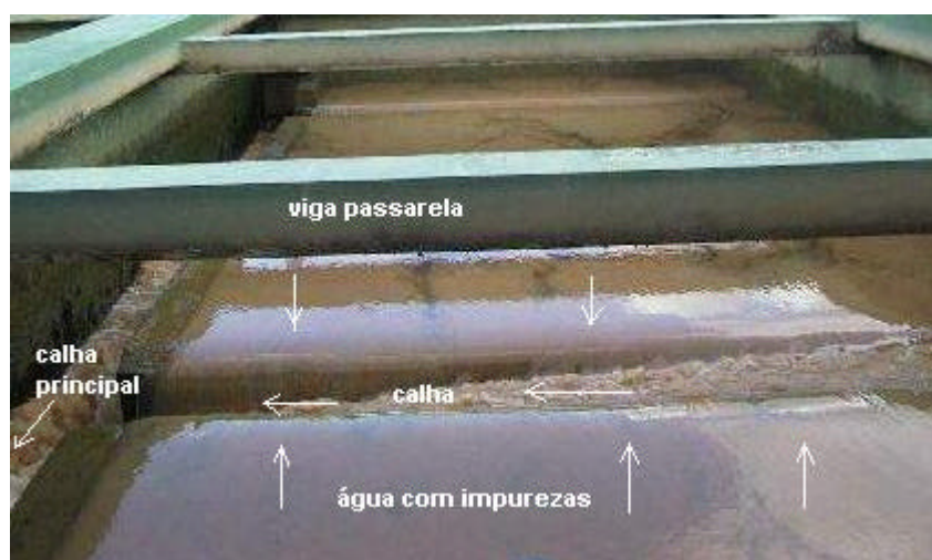
Figura 22 - Lavagem de filtros. Na foto de cima o início (areia fluidificando) e na de baixo a lavagem em pleno funcionamento (observar o funcionamento das calhas coletoras)
