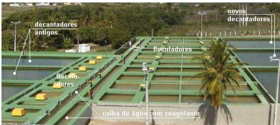
Figura 12 – - Floculador mecânico vendo-se as tampas (amarelas), para proteção do motor de acionamento do misturador. (ver detalhe figura 13)
