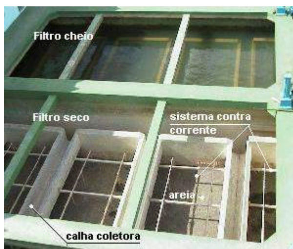
Figura 23 - Fotografia de um filtro seco onde se vê a malha de tubos do sistema fixo de contracorrente ou lavagem auxiliar
