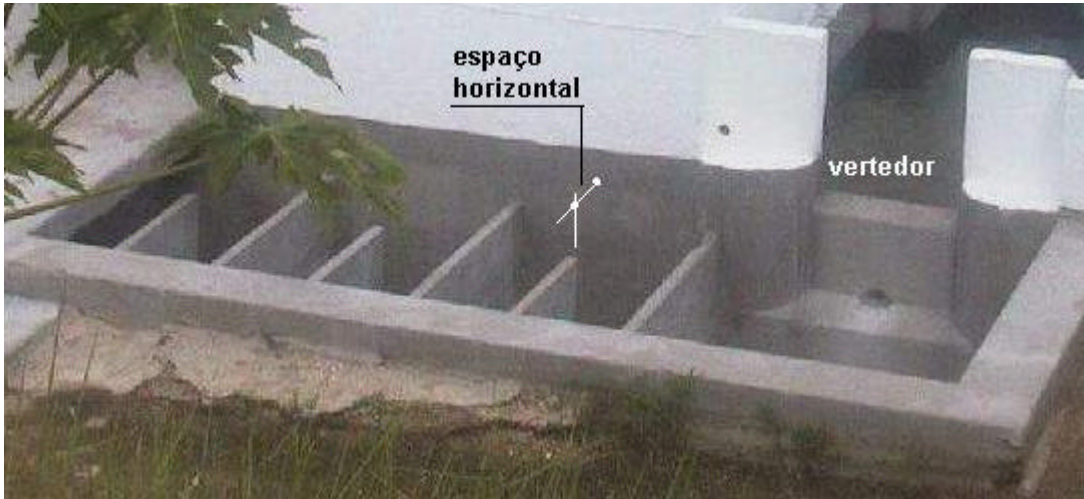
Figura 11 – - Floclador em chicanas verticais (seco) vendo-se, à direita, o vertedor para medição de vazão. ETA Alto Branco, CAGEPA, Campina Grande.
