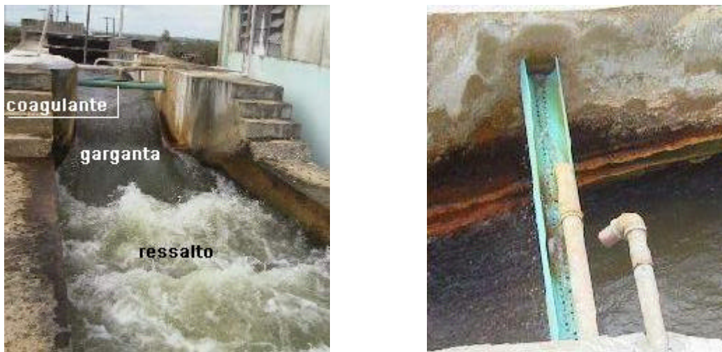
Figura 8 – Calha parshall em operação como misturador rápido ETA Gravatá, CAGEPA, Sistema Boqueirão-Campina Grande
