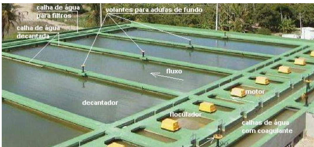
Figura 16 – - Decantador convencional de fluxo horizontal- ETA Gravatá, CAGEPA, Sistema Boqueirão-Campina Grande.
