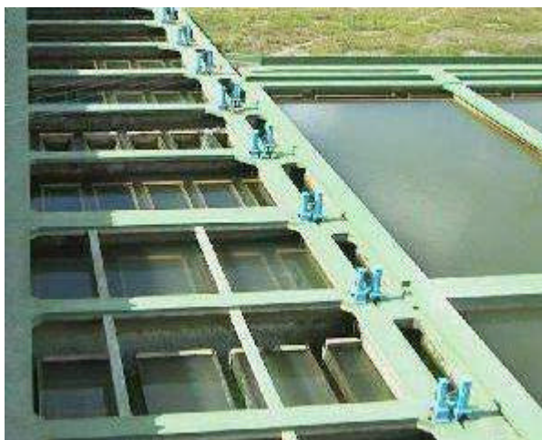
Figura 21 - Vista parcial da bateria de filtros da ETA Gravatá
