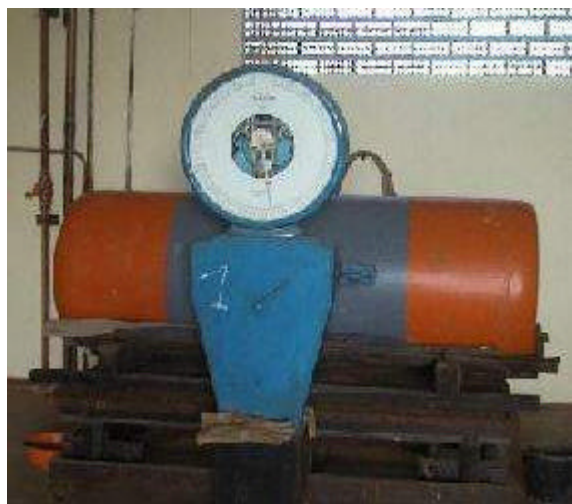
Figura 26 - Balança de cloração para cilindro de cloro gasoso
