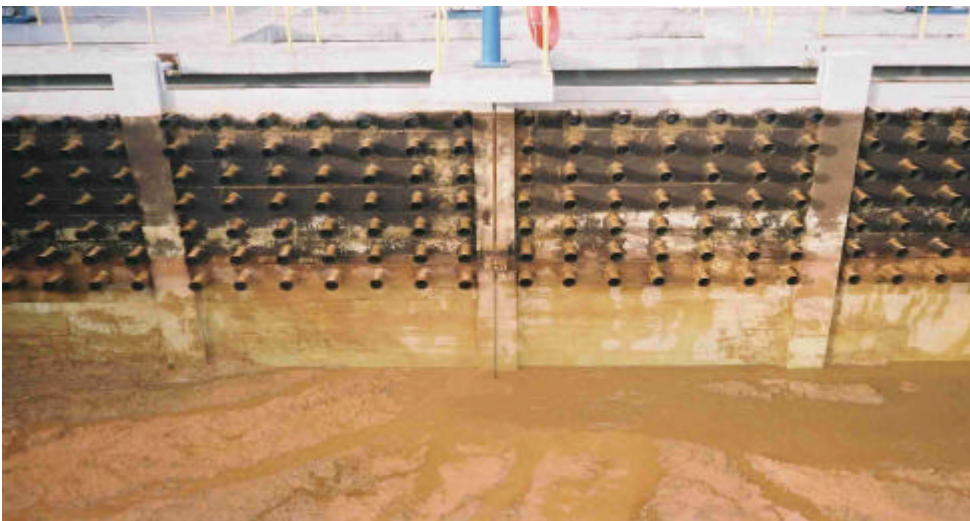
Figura 18 - Um detalhe da calha coletora de água decantada
